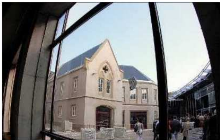
Le quartier s'était ému, lorsque les murs de la chapelle, avaient été démolis. Ce n'était que pour mieux les reconstruire et préserver leur cachet historique. Idem pour l'ancien commissariat, qui n'est jamais apparu aussi majestueux.
