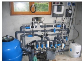
Exemple de local technique de piscine
