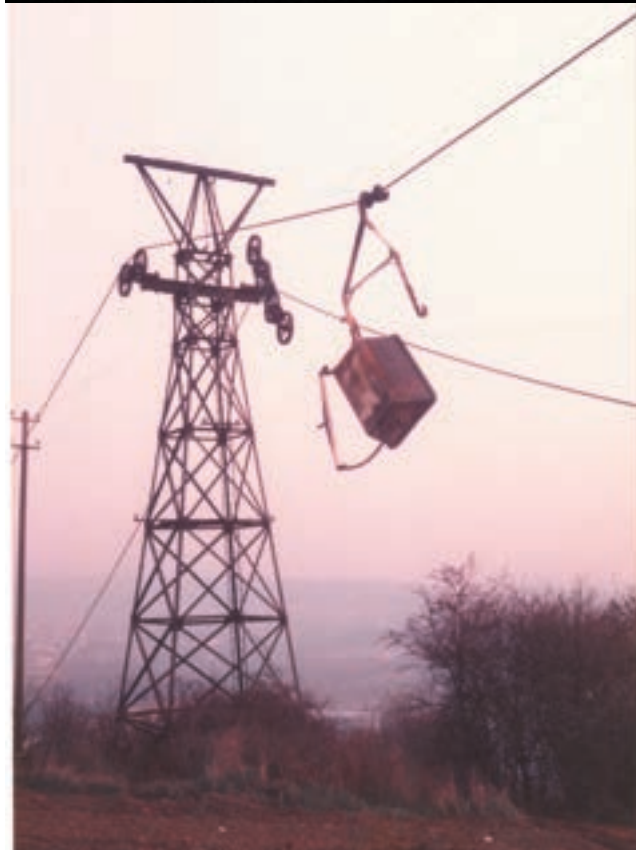
Rupture de câble en 1983
