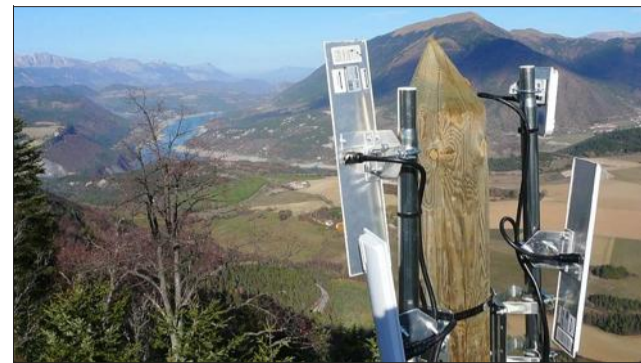
En Isère, Alsatis a accompagné la montée en débit, en installant des relais radio permettant de ne pas utiliser les lignes téléphoniques.
