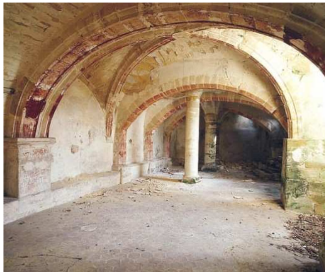
Autre chapelle vénérable de Meulan : la chapelle Sainte-Avoie dans l'enceinte de l'ancien château des comtes de Meulan bâtie au 10 ème siècle et consolidée au 18 ème . Son état depuis cette photo s'est considérablement délabré.
