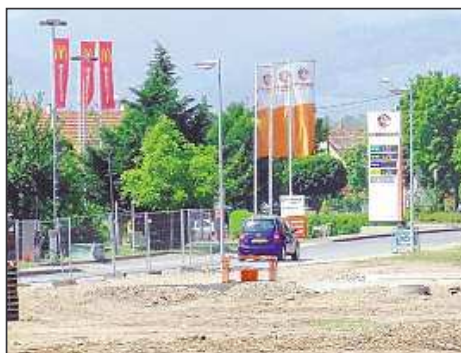
Les premières constructions devraient s'implanter prochainement. Ouverture des commerces en 2008. Photo BH
