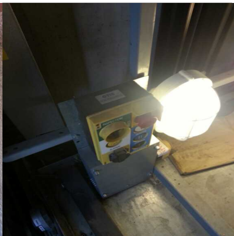
Le boîtier d'inspection.
