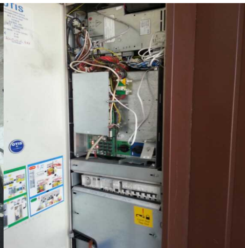
L'armoires de manoeuvre.
