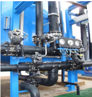
Fig.5 – Echangeur d'ions et sa façade hydraulique
